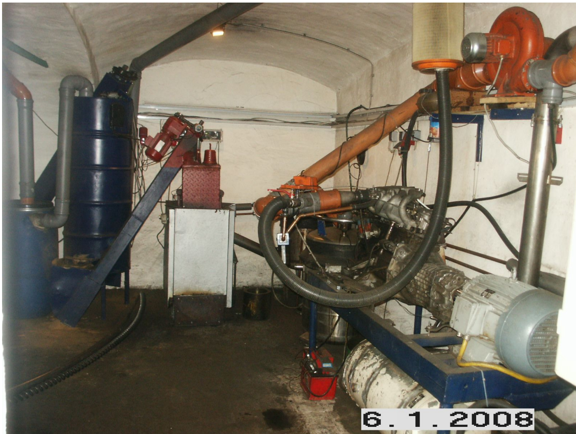
Abb.2: Anlage nach 2 Jahren Betrieb
